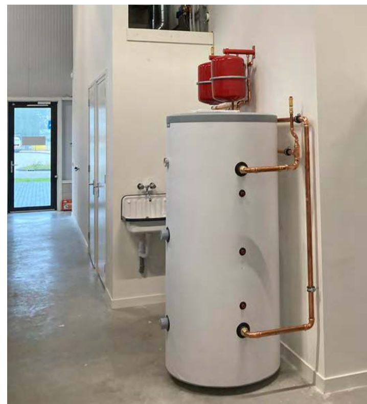
Afb.6. Warmtepomp installatie in bedrijfshal
