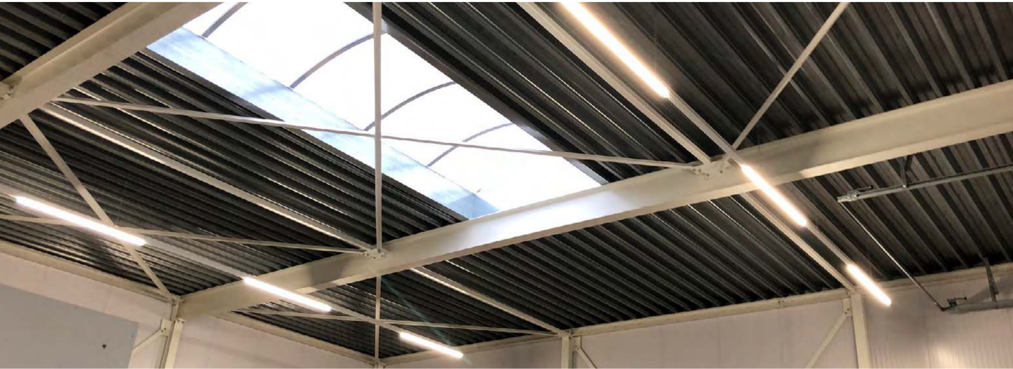
Afb. 4. Lichtstraat in bedrijfshal
