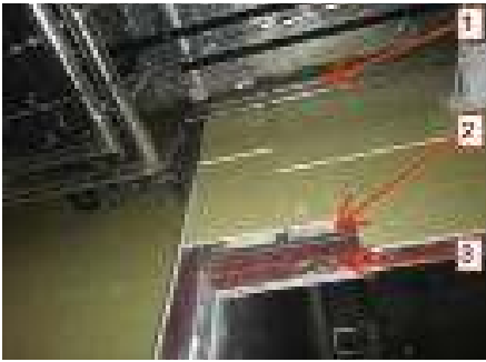
Foto 6. Fout! Een slordige uitvoering van een 60 minuten brandwerende lichte metalstudwand.
