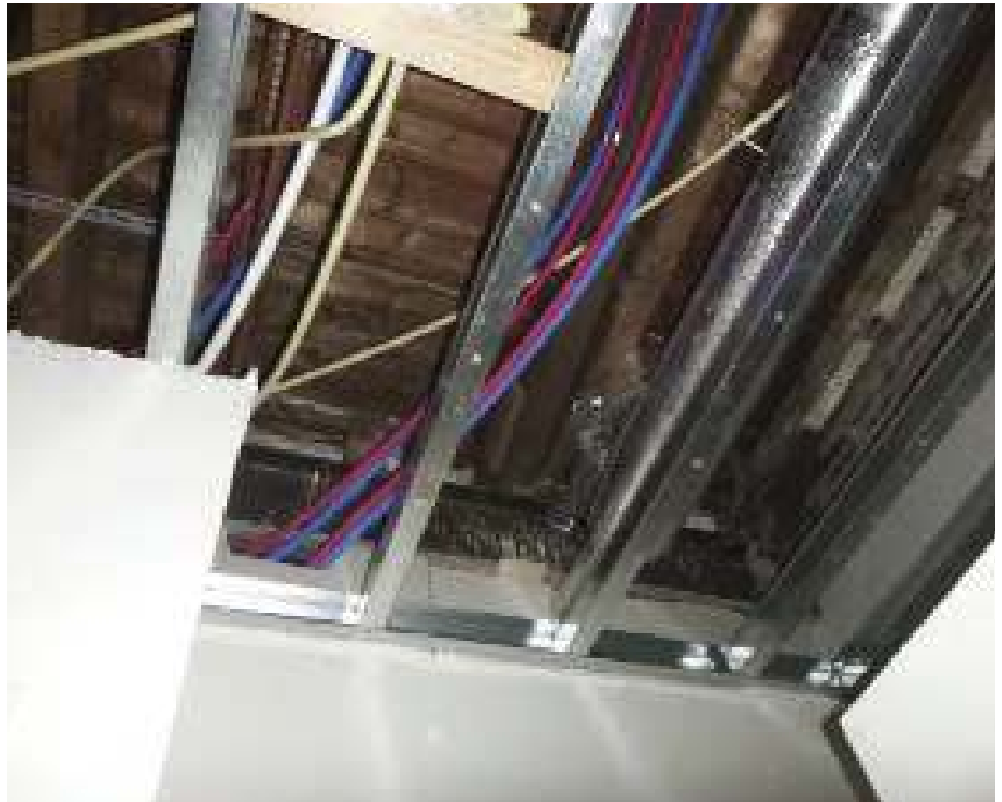
Foto 7. Fout! Er is onvoldoende nagedacht over de realisatie van de brandwerendheid van de leidingen die boven het vaste (gips)plafond door bijvoorbeeld een schachtwand voeren. Ook is er onvoldoende nagedacht over het brandwerend uitvoeren van de stalen draagconstructie die onder de houten vloerconstructie aanwezig is. Bij bezwijken van deze draagconstructie bezwijkt immers ook de bovenliggende houten vloerconstructie.
