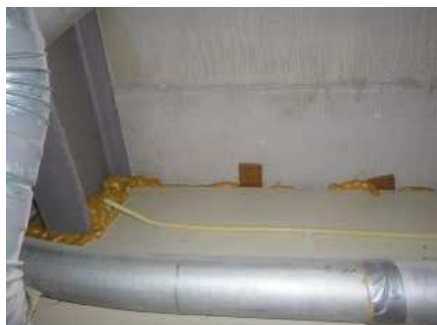
Foto 1: Fout! De naden rondom de lichte wandconstructie, de opening rondom de stalen ligger en de sparing rondom de kabeldoorvoer zijn allemaal afgedicht met brandwerend PUR-schuim.
