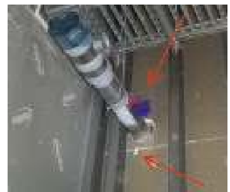
Foto 2: Fout! Onder en boven het luchtkanaal is geen horizontale raveling aanwezig, waardoor de sparing rondom het luchtkanaal lastig brandwerend af te dichten is.
