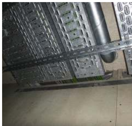
Foto 4. Fout! Aan de zijde van de niet-brandwerende voorzetwand is nauwelijks ruimte tussen de kabels en de wand. De kabeldoorvoeren moeten aan beide zijden van de betonnen wand brandwerend worden afgewerkt OP de betonnen wand. Als de niet-brandwerende voorzetwand strak aansluit tegen de doorvoer kan de brandwerende voorziening niet goed zijn werk doen waardoor branddoorslag kan plaatsvinden.
