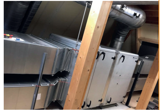
Bron: Installatiebedrijf Ranzijn
