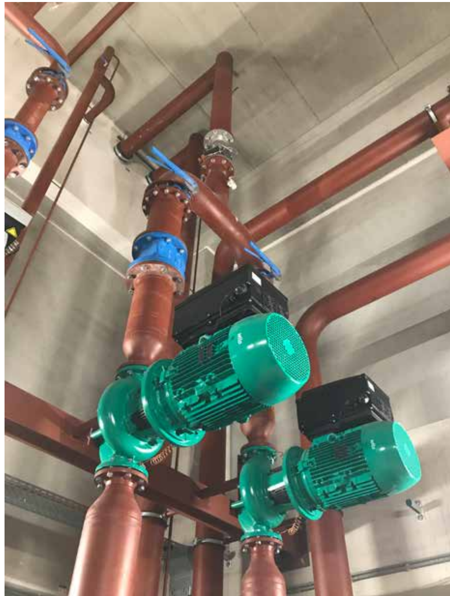
Alle W-installaties zijn conform het OBO (ontwerpen, bouwen, onderhouden) principe van vanPanhuis Hoogeveen en de BREEAM-NL 'Outstanding' certificeringscriteria gerealiseerd.
