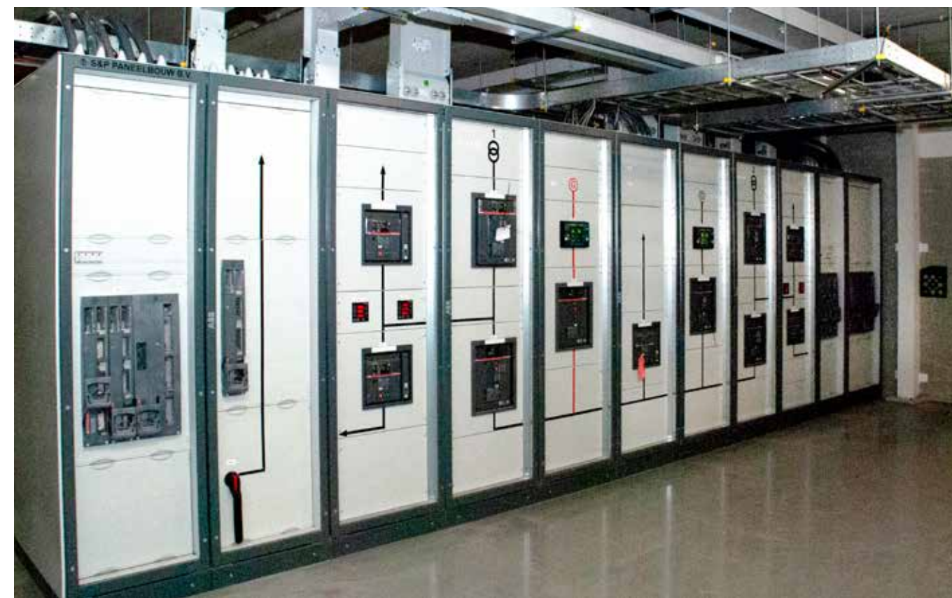
De laagspanningsverdelers in het nieuwe distributiecentrum van Lidl in Oosterhout zijn in opdracht van Kromwijk Elektro geëngineerd, geleverd en gemonteerd door S&P Paneelbouw BV.
