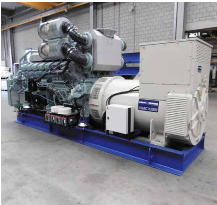
Noodstroomaggregaat in de productiehal van Zwart Techniek.
