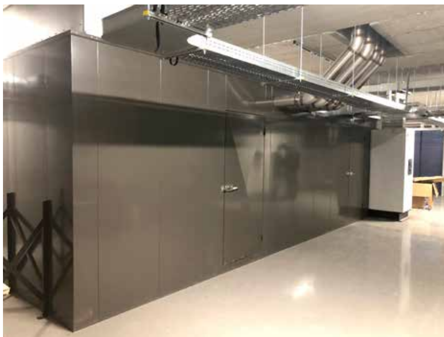
Noodstroomaggregaat inclusief omkasting, ingebouwd bij DC Lidl in Oosterhout.
