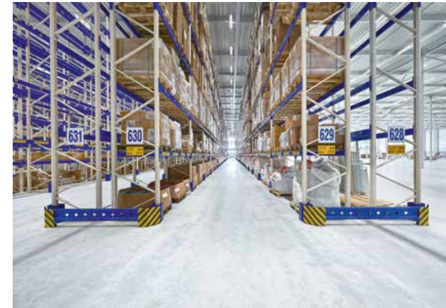
In de hallen blijft de verlichting stevast op een minimale lichtoutput branden, zodat medewerkers niet met donkere hoekjes worden geconfronteerd.
