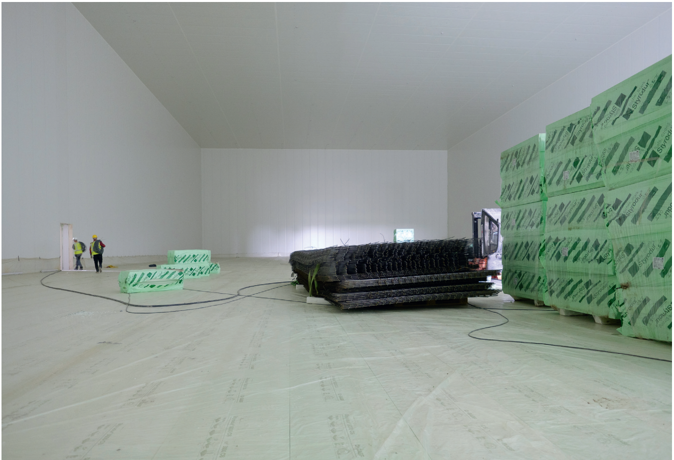
ONDER DE VLOER VAN DE VRIESCEL LIGT VLOERVERWARMING TEGEN HET BEVRIEZEN VAN DE ONDERGROND
