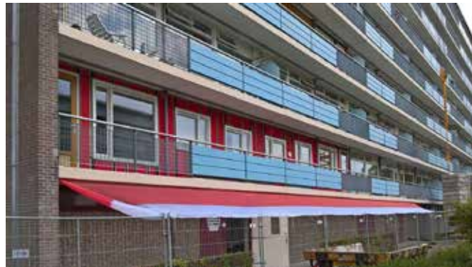
De glazen gevels aan de achterzijde worden vervangen door houtskeletbouwelementen met kunststof kozijnen.
