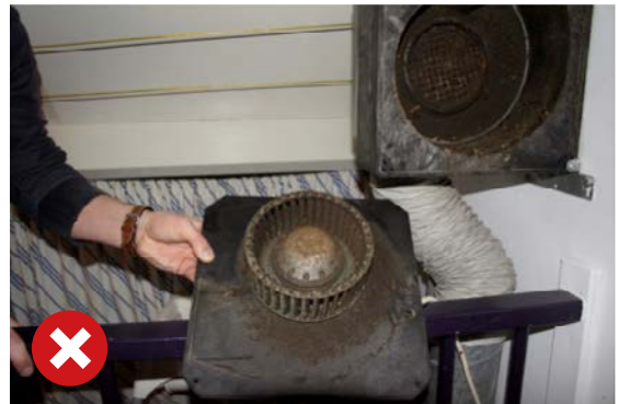
Sterk vervuilde ventilatie-unit zorgt voor minder vermogen, meer geluid en extra energiegebruik.
