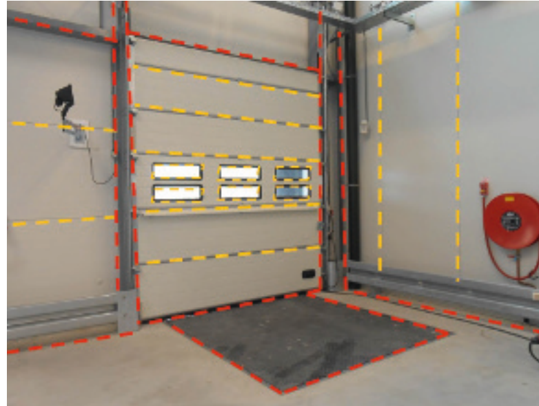
Potentiële luchtlekken bij bedrijfsdeur
