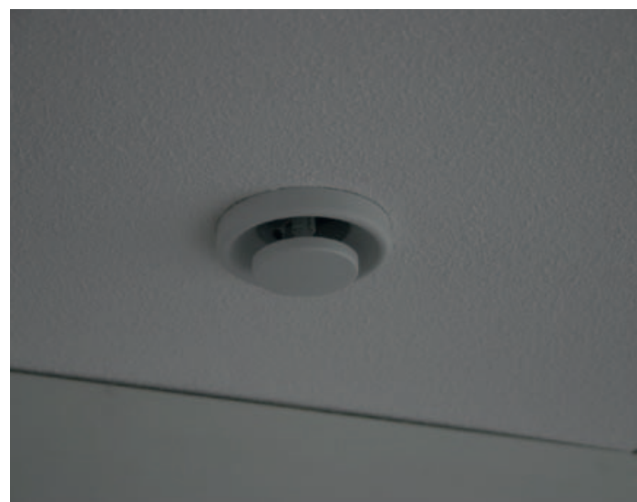
Bij systeem C moet ook in de slaapkamer een ventilatieafzuigpunt komen om de luchtkwaliteit te borgen (foto's: Richard Mooi).
