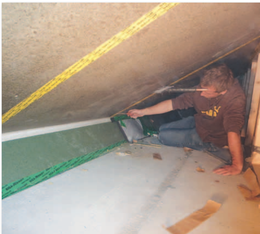
Kwalitatieve beoordeling muurplataansluiting (Emergo Houtconstructies) tijdens luchtdichtheidsmeting.
