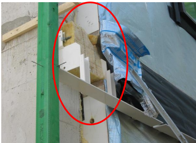
Foto boven: Isoleren tussen de brackets van een geveldrager is lastig uitvoerbaar (zie ook 4.4.1.)
