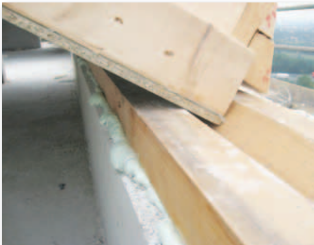
Foto 2a: Bij de aansluiting van een dakelement op een muurplaat is sprake van twee dichtingen: 1) dichting tussen muurplaat en borstwering/vloer en 2) dichting tussen dakelement en muurplaat (deze is hier niet aangebracht).
