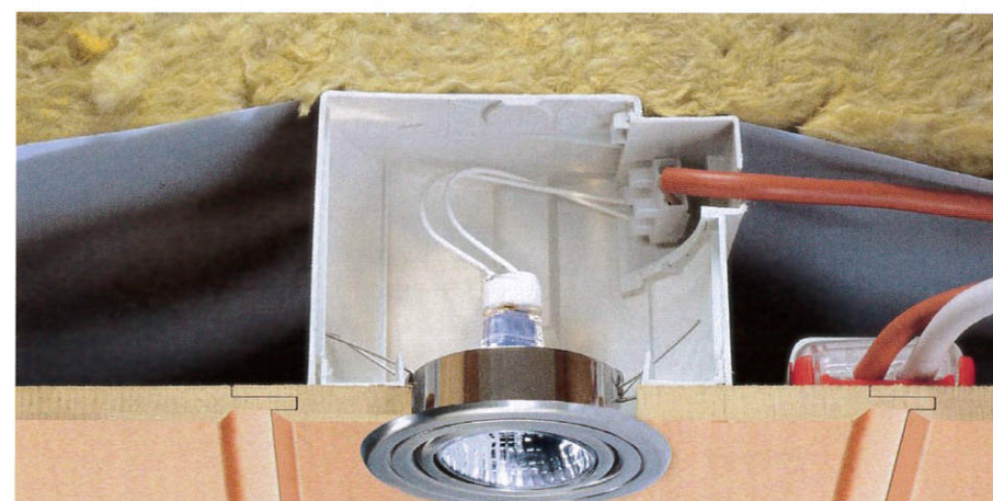
Ontwerp een leidingspouw zodanig dat dampremmer en luchtdichting niet worden doorbroken. Foto: Heliä.
