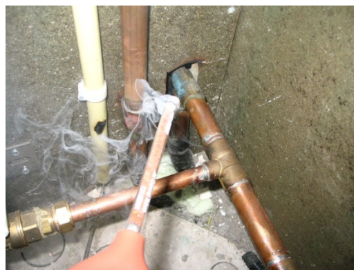
Visuele bepaling luchtlek met een rookbuisje
