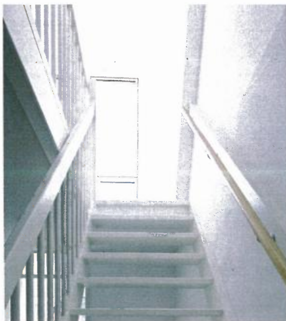
In de zomersituatie fungeert het trappenhuis als een natuurlijk afvoerkanaal, in de wintersituatie brengt het juist licht van buiten tot beneden in de woonkamer.
