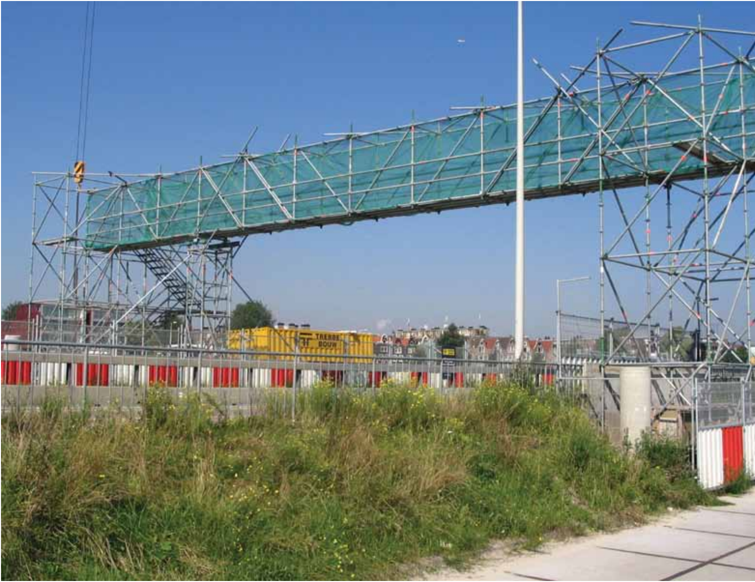
Het bevoegd gezag bepaalt van geval tot geval of er een bouw- of sloopveiligheidsplan nodig is; in dit geval is er sprake van overbouwingen/bruggen en is al snel een Bouwveiligheidsplan vereist. Foto: Nieman-Kettlitz Gevel- en Dakadvies B.V.
