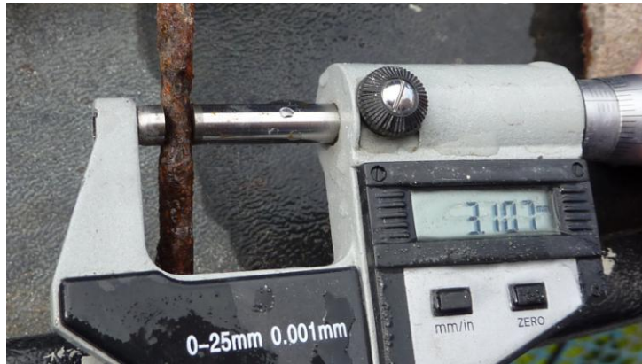
Analyse en destructief onderzoek kopgevels, controleren restdikte ankers, Heemstede.
