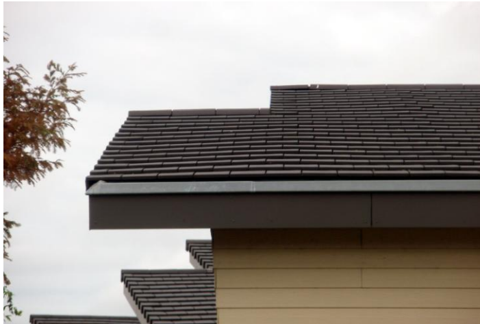
Onderzoek naar doorzakken dakoverstek enkele jaren na oplevering, Leidschenveen.
