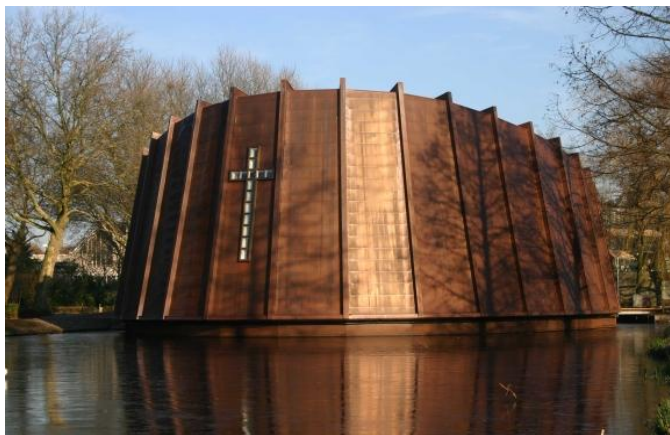
Bevestiging metaalplaten boven sloot... Risico?
