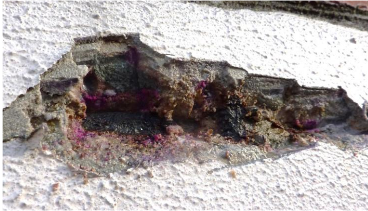
Uitvoerige analyse en onderzoek van lateien, controle betoncarbonatatie/chlorideaantasting, Lelystad.
