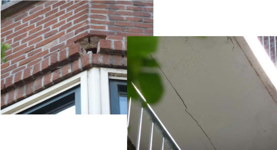
Zichtbare schade aan gevels en betonnen onderdelen, wooncomplex te Rotterdam.
