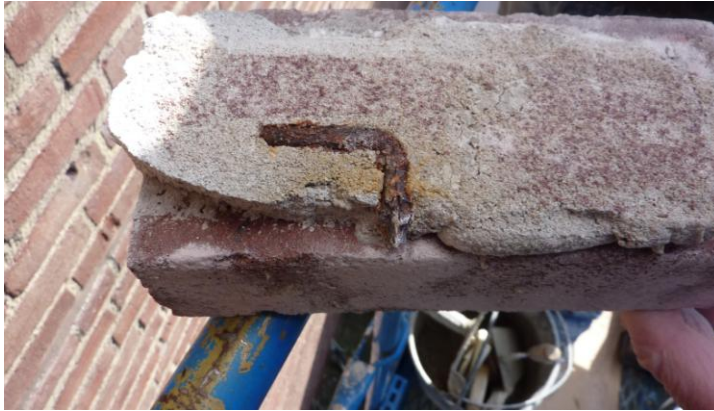
Analyse en destructief onderzoek kopgevels, doorgeroeste spouwankers, Heemstede.
