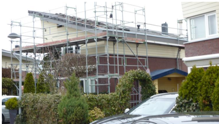
Onderzoek naar doorzakken dakoverstek enkele jaren na oplevering, Leidschenveen.
