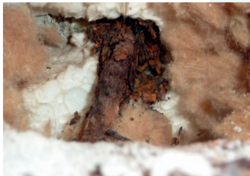
Het stalen spouwanker is verpulverd en afgebroken.
