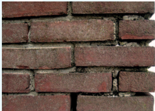
Het voegwerk is op de hoek volledig uitgespoeld.
