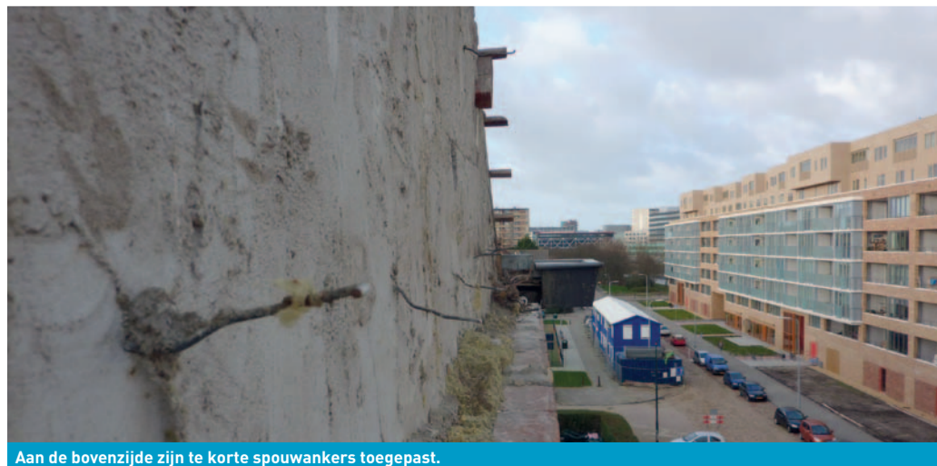
Aan de bovenzijde zijn te korte spouwankers toegepast.
