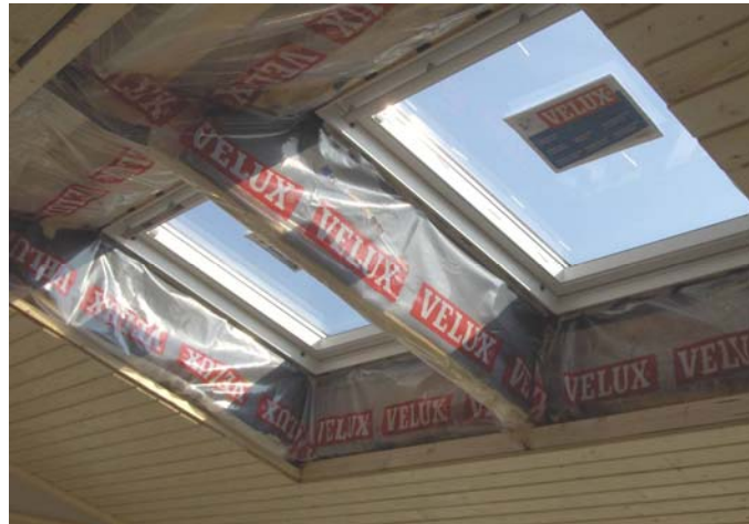
Bij dakdoorbrekingen (dakramen) dient extra aandacht aan de lucht- en dampdichtheid te worden besteed. Hier is een dampremmende folie zorgvuldig aangebracht en afgeplakt. Bron: Velux Nederland B.V.
