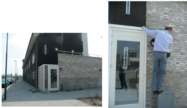
Figuur A 9200-7 Voorbeeld onvoldoende afscherming vluchtroute. Foto's Nieman Raadgevende Ingenieurs B.V.
