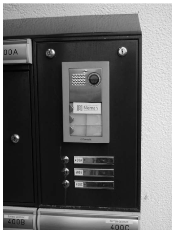
Figuur A 9200-1 Intercom met videofoon. Foto Nieman Raadgevende Ingenieurs B.V.
