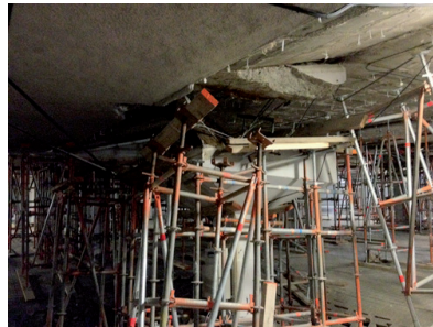
Figuur 4 – Acuut instortingsgevaar bij winkelcentrum 't Loon in Heerlen
