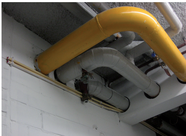
Figuur 2 – Veel bestaande scheidingen tussen brandcompartimenten voldoen niet aan de eisen van Bouwbesluit niveau bestaande bouw
