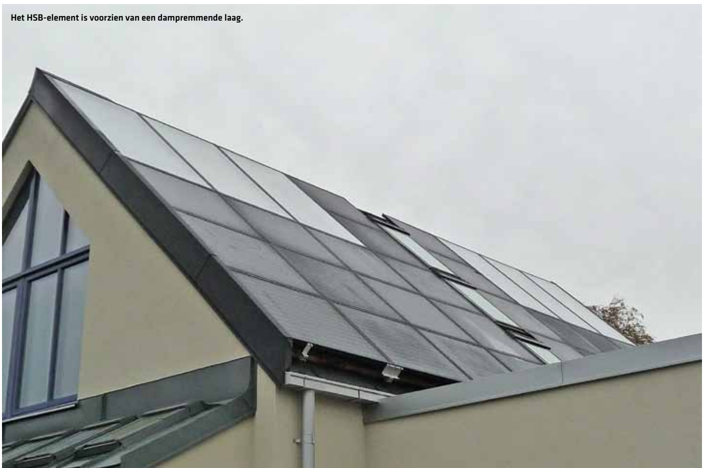
Het dak is bedekt met zonnecollectoren en PV-cellen.
