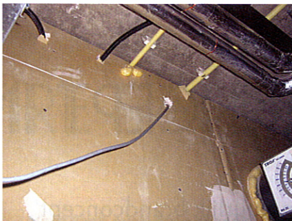
Voorbeeld 7. Fout! Slordige uitvoering van een 30 minuten brandwerende lichte MS-wand.
