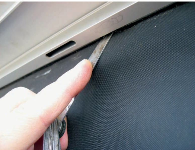
De aansluiting van het buitenafdichtingsrubber is niet strak en sluit niet aan
