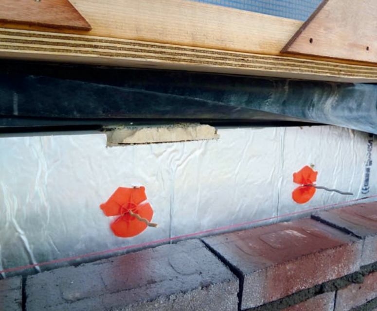
Isolatie sluit niet strak aan tegen het stelkozijn
