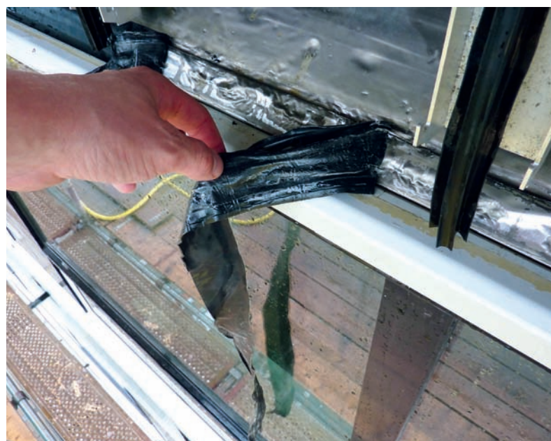
De waterdichting (het tape) laat los
