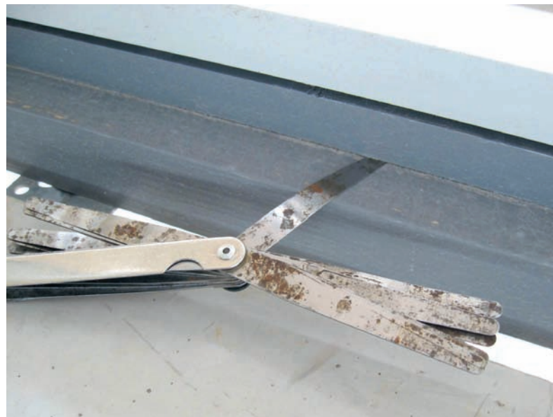
Het dubbelhouten stelkozijn is niet luchtdicht verlijmd
