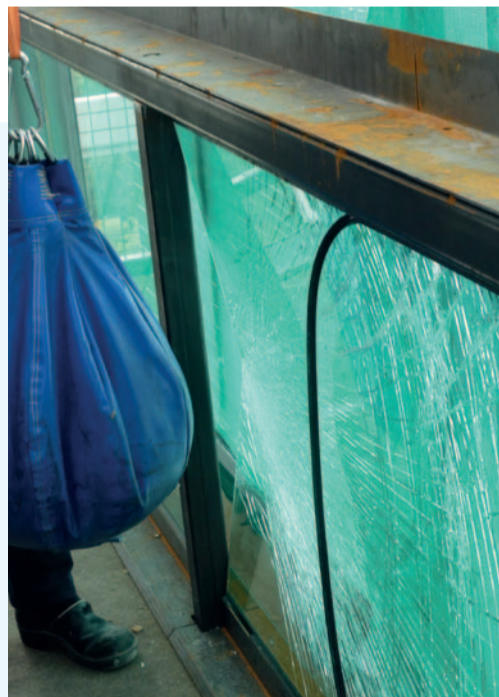
De door de glasparelzak-slinger aangebrachte schade aan een gelaagde ruit in een balkonhek: de glasplaat is gebroken en buigt circa 60 mm door.
