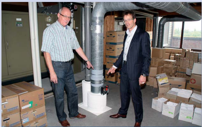
Robert Krijgsman (links) van de Stichting Sonneburgh en Denis Hub (rechts) van de SOR bekijken een leidingdoorvoer die brandwerend is bekleed.
