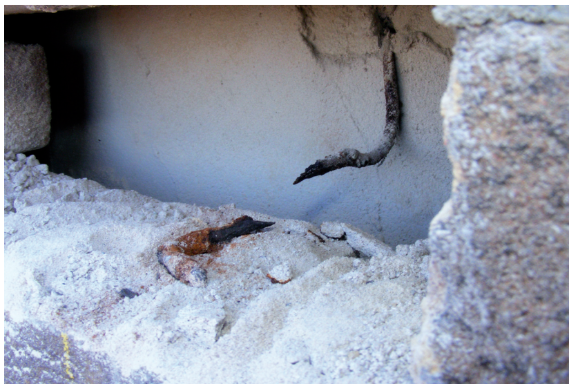
Vocht heeft hier de verzinkte spouwankers aangetast. Met grote schade tot gevolg.
