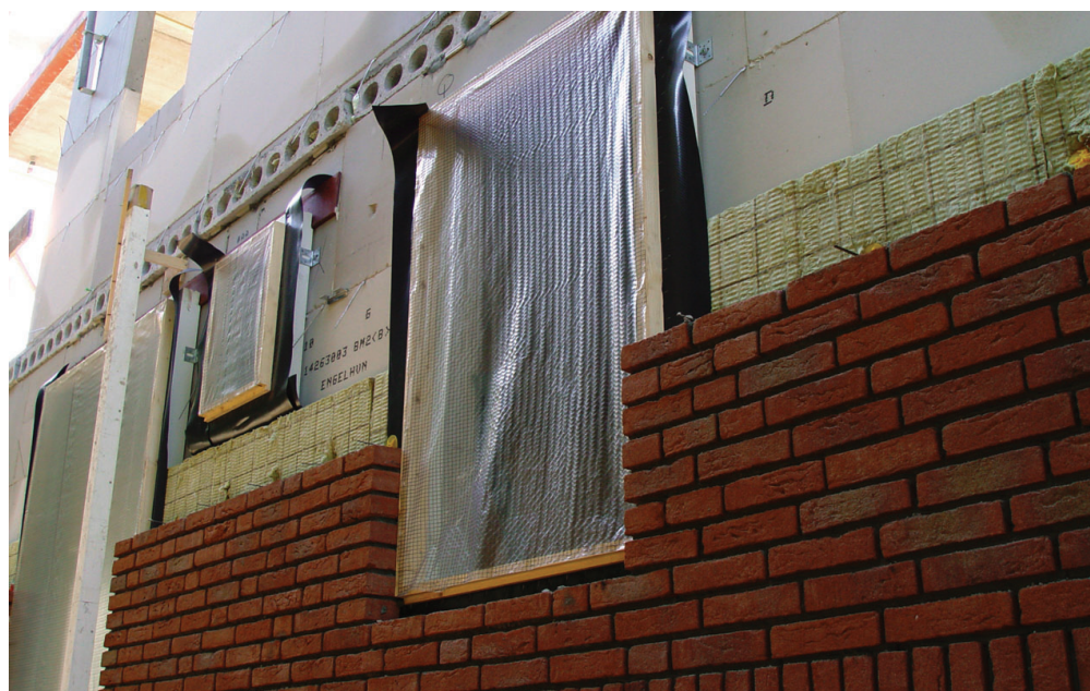
Let er bij gebruik van smallere bakstenen op dat de spouwankers de juiste lengte hebben.
