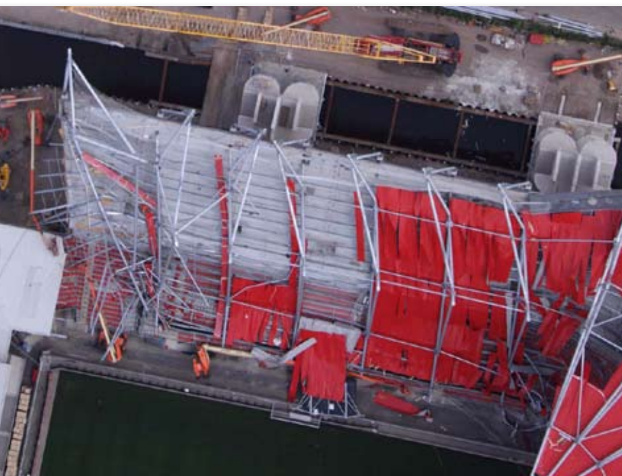
Bovenaanzicht instorten van de overkapping van de aanbouw van het Grolsch Veste Stadion te Enschede op 7 juli 2011. © Foto: KLPD DLV.
